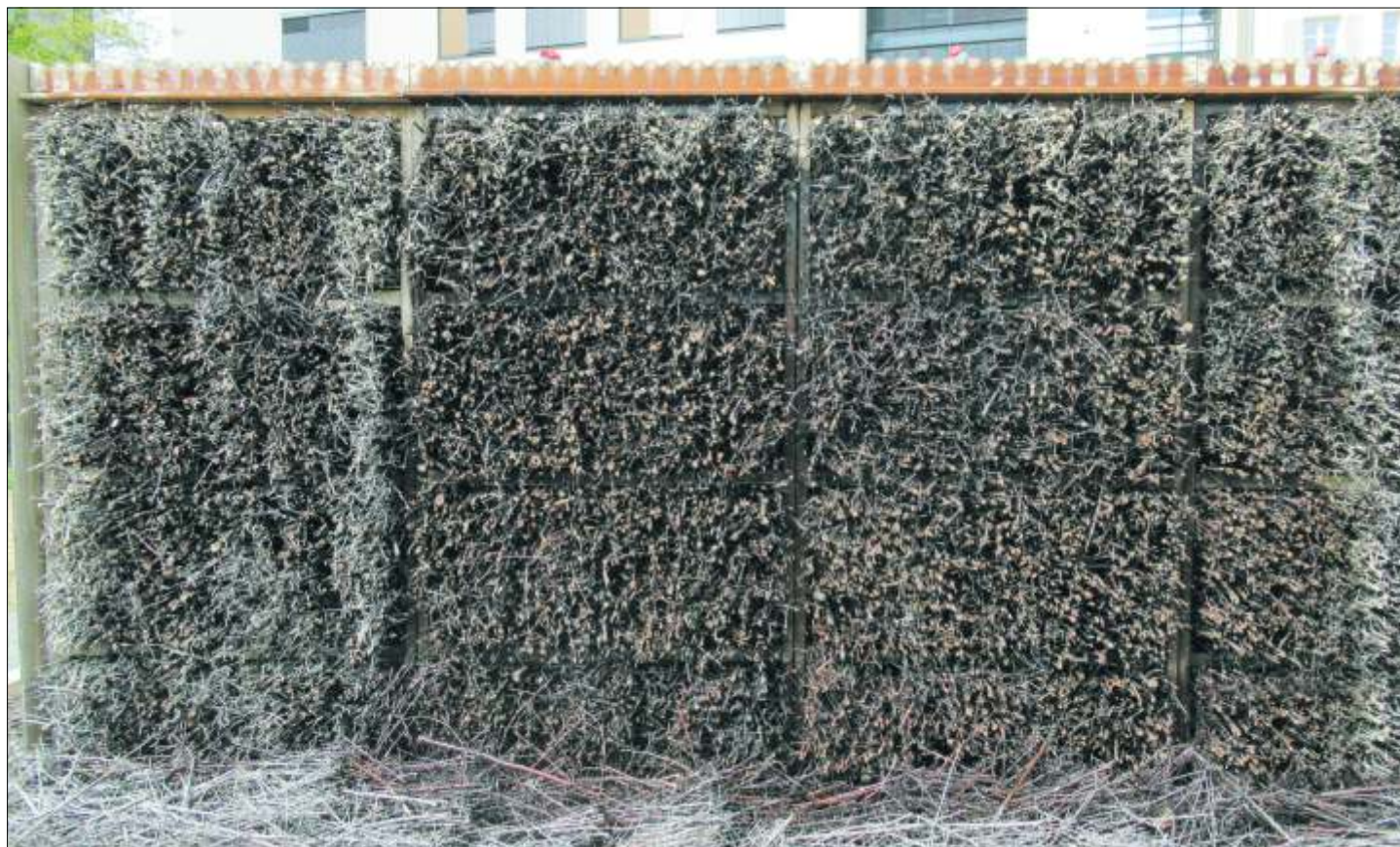
Rund einen Monat nach Inbetriebnahme weisen die Gradierwerke im Remspark schon die ersten Schäden in Form von trockenen Stellen auf. Für die BI Stadtklima nur einer von mehreren Kritikpunkten.
