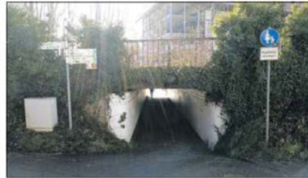
Ab dem 20. April wird die Unterführung beim Fehrle-Parkhaus gesperrt. Laut der Deutschen Bahn müsse das Bauwerk dringend abgesichert werden. Foto: Stadt Gmünd
